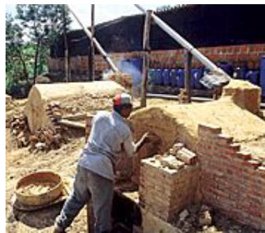
Os gases emanados dos fornos são canalizados e, após a formação do licor, há a decantação em tonéis de PVC
